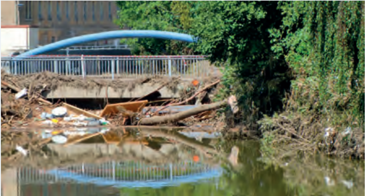
Abbildung 6-16: Verklausung der Brücke Bahnhofstraße in Ostritz (Foto: LTV)
