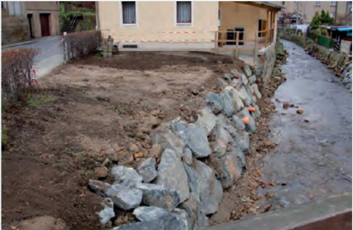
Abbildung 9-79: Maßnahmen Sofortsicherung 2010 (Foto: Stadtverwaltung Bad Schandau)
